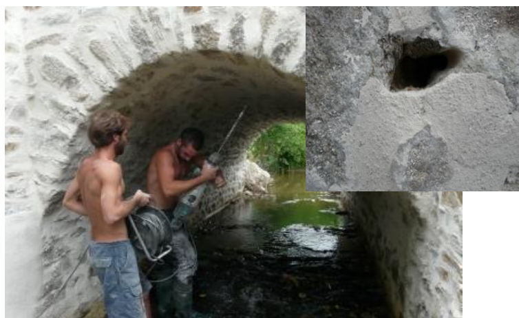
Aménagement d'anfractuosités sous un pont © Julien JEMIN
